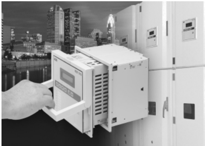
Figura 4. Relevador de protección multifunciones microprocesado REF610 marca ABB Fuente: http://www.schneider-electric.com//
