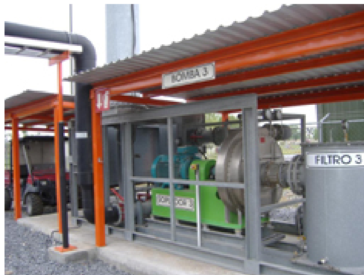
Fig. 1.1.2.(4). Planta de captación de gas metano en Monterrey.
