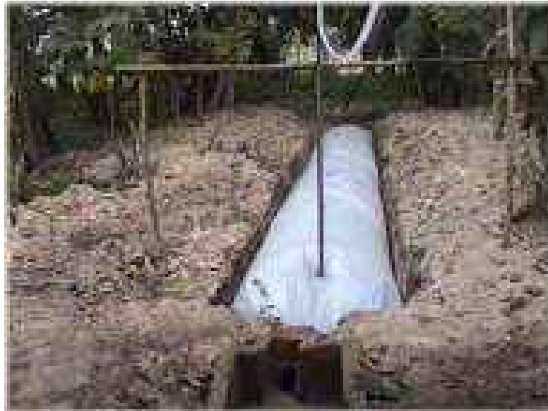
Fig. 2.2.1. (2). Biodigestor de globo.
