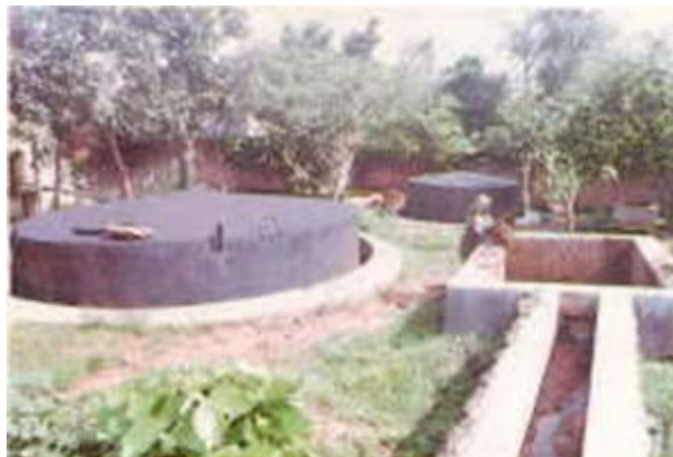
Fig. 2.2.3.(1). Biodigestor de Domo flotante en paralelo.
