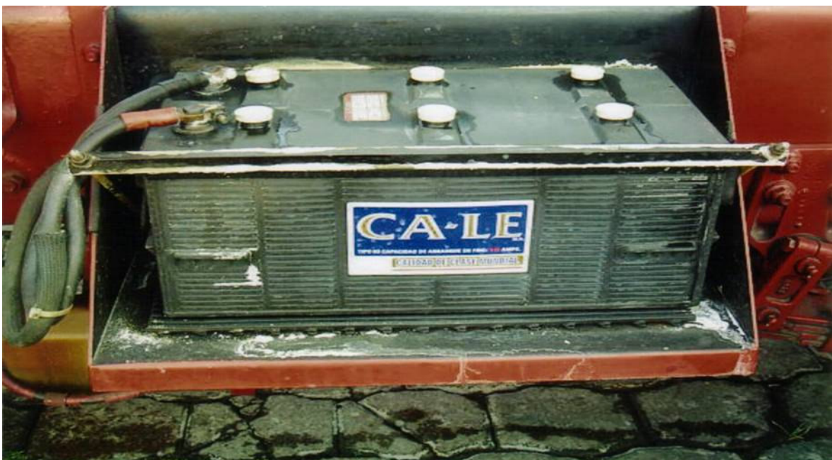
Fotografía 14. Batería, 12 Volts, 180 amperes.
