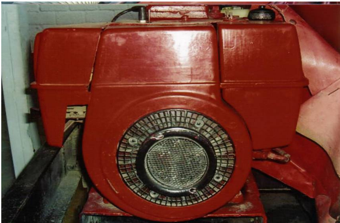
Fotografía 6 Bomba; Marca WATEROUS, 1500 GALONES A 1500 RPM vista principal
