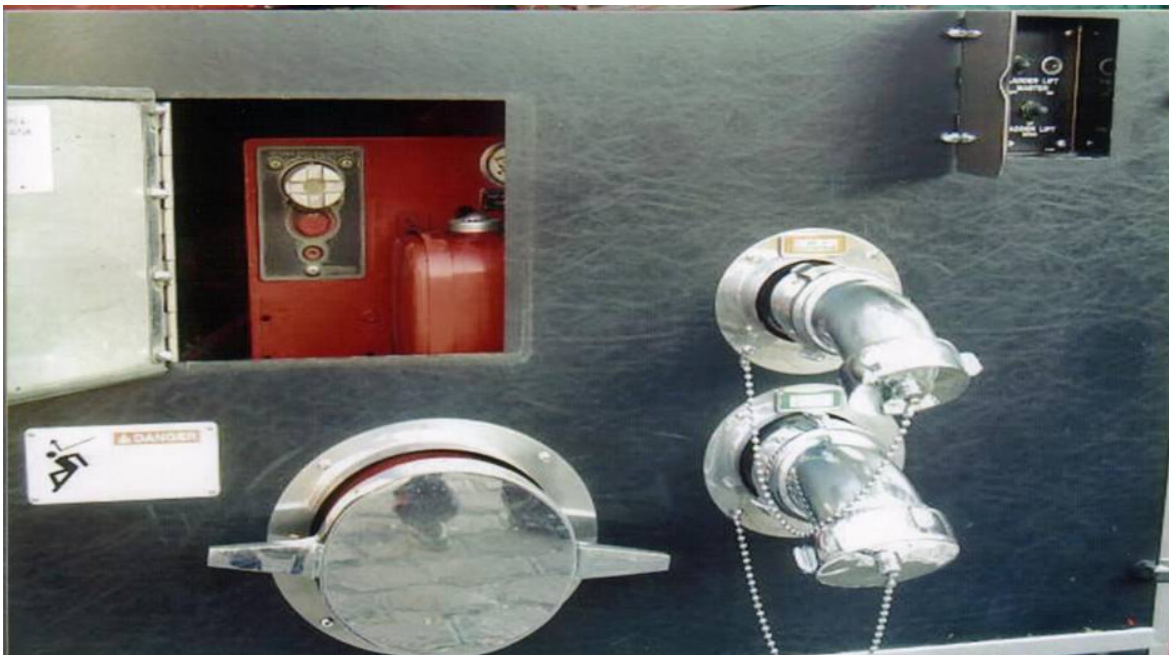
Fotografía 8: líneas vivas de 1 ½", 2 – 21/2 y 2 succionadores. Cada salida tiene manómetro de descarga y muestra a cuantas libras entra el agua.
