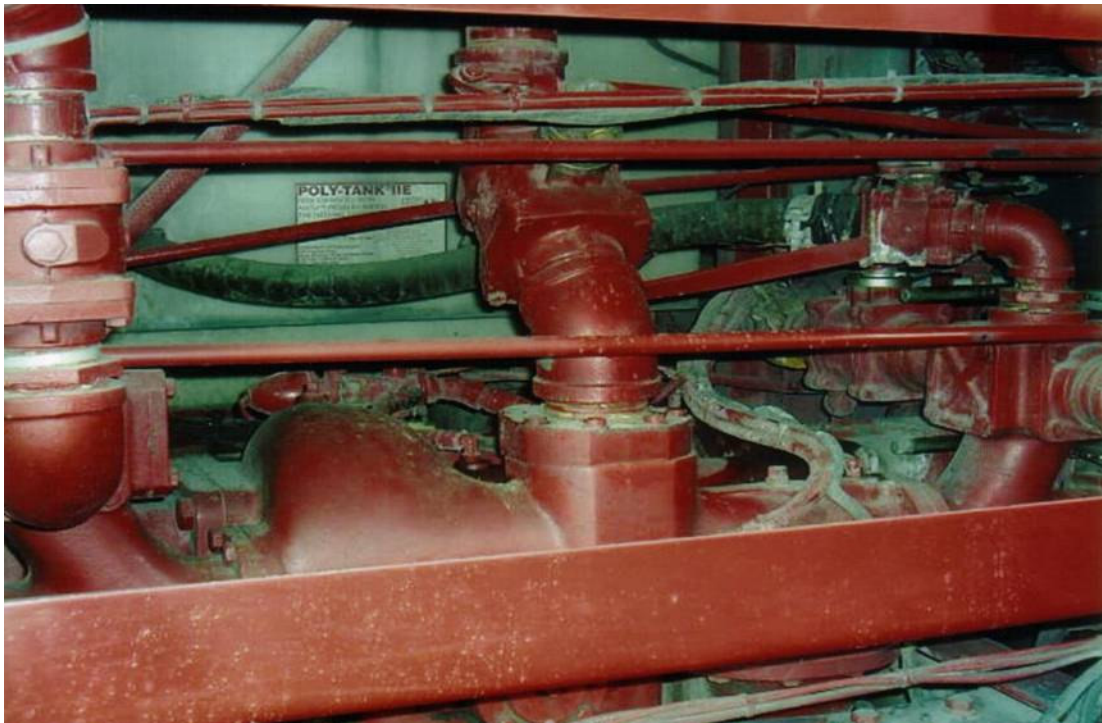
Fotografía 7 Bomba; Marca WATEROUS, 1500 GALONES A 1500 RPM vista posterior
