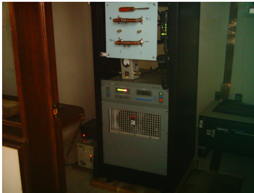
Figura 5.13: Transmisor de frecuencia fija.
