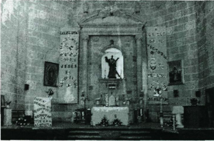
Convento de San Andrés. Detalle del interior de la iglesia, ahora en parte despojada de su recubrimiento original.
