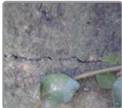
Foto. Fragmentación de rocas debido a penetración de plantas (Chavarría, F)
