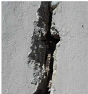
Muro del edificio de Molienda Lado Este Cerca de Falla
