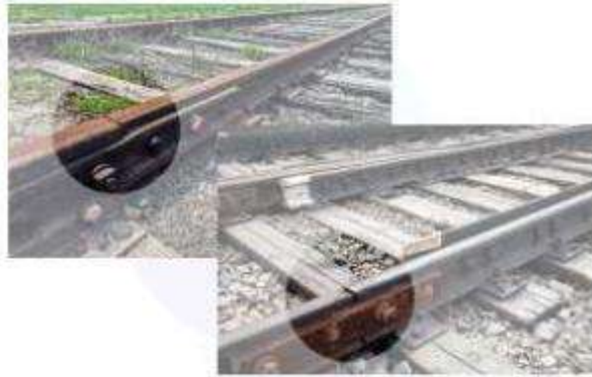
Figura 1. Dilatación térmica en las vías del tren.
