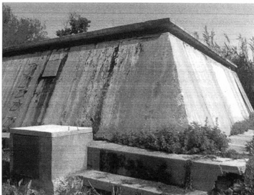
Tanque regulador de agua potable
