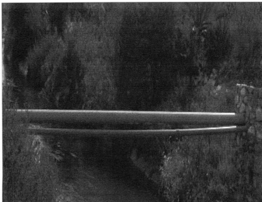
Tubería de agua potable
