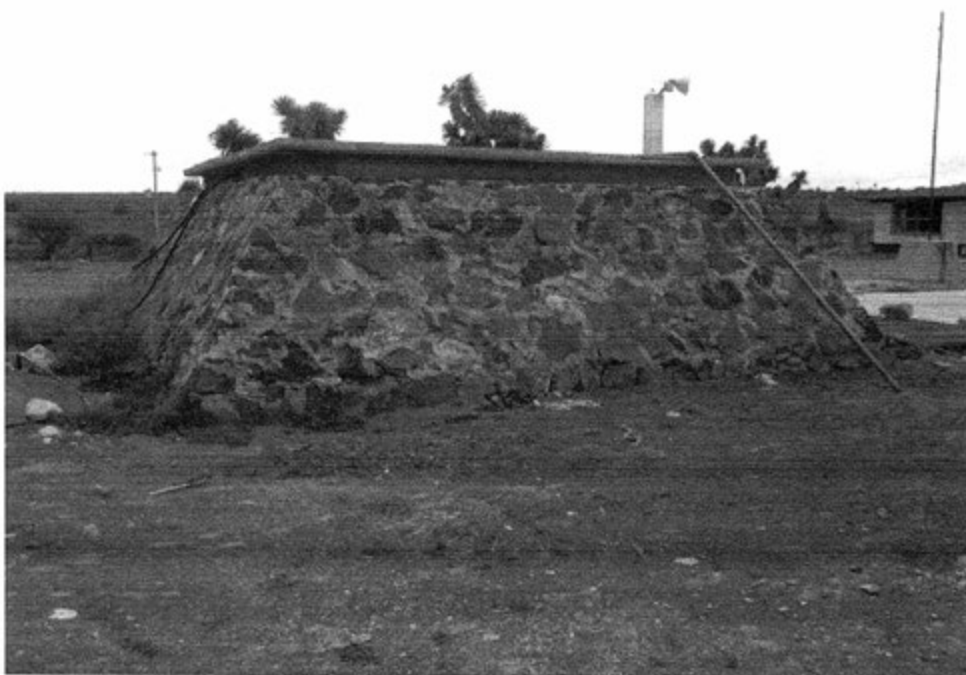
Pileta que brinda servicio de agua potable
