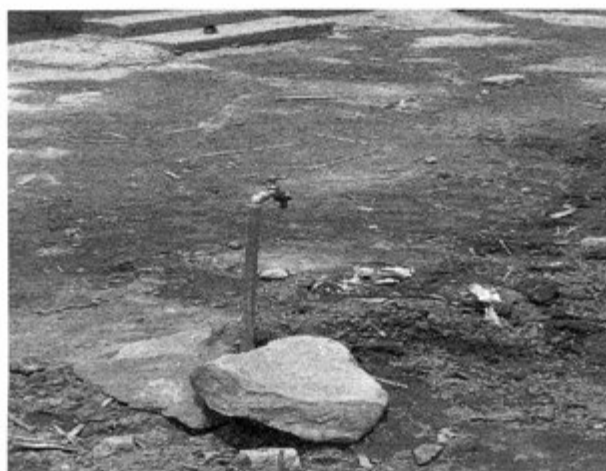
Llave de agua potable
