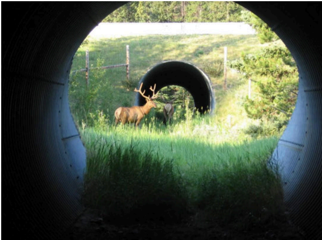
Figura 7. Paso de fauna subterráneo
