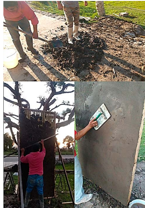
Figura 12. Proceso de preparación y colocación del mortero para los muros de bajareque
