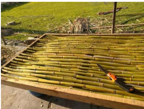
Figura 11. Vista del entramado de carrizo
