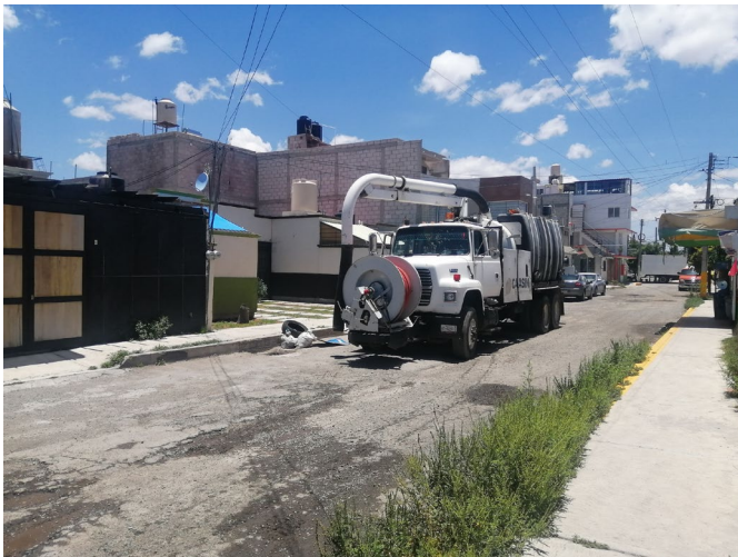
Figura 7. Desazolve de rejilla pluvial por parte de CAASIM. Fuente: creación propia.
