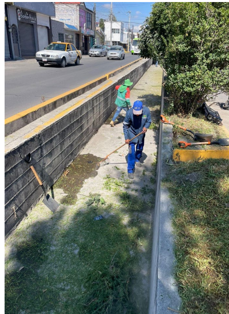
Figura 11. Intervención de Servicios Públicos Municipales de Mineral de la Reforma en dren Tulipanes-Tuzos. Fuente: Habitante del fraccionamiento.
