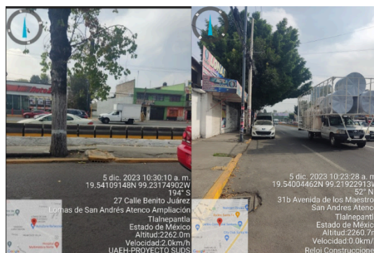
Figura 6: Drenaje sobre Av. De los maestros. Izquierda: alcantarilla con azolve del 70%, derecha: alcantarilla en buen estado (fuente propia).
