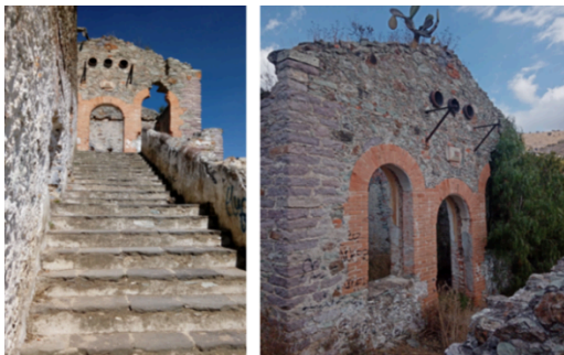
Figura 17: Casa de máquinas de bombeo con placa fechada en 1901. Fotografía de autor.
