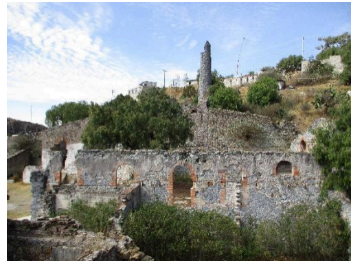
Figura 21: Vista lateral de casa del malacate y chimenea al fondo, que muestra el deterioro y el crecimiento de hierba. 2022. Fotografía de autor.
