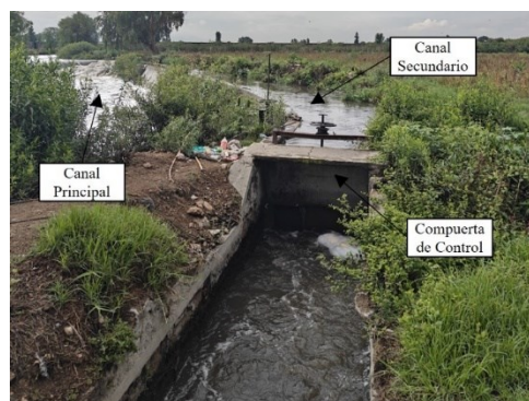
Figura A3. Compuerta de control para suministro de agua desde el canal principal hacia los sembradíos. (Coordenadas Latitud: 20.1290 N, Longitud: -99.2847 W).
