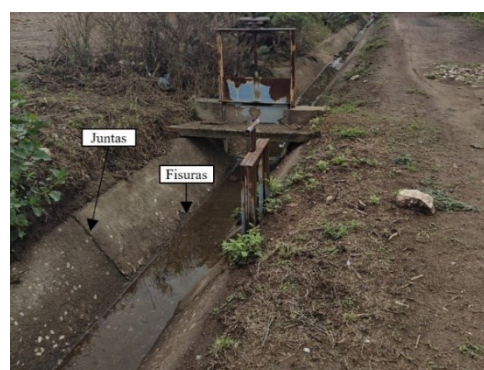
Figura A4. Compuertas de control hacia los sembradíos, se observa el fondo de concreto y los posibles puntos de fuga en las juntas y fisuras. (Coordenadas Latitud: 20.1290 N, Longitud: -99.2847 W).
