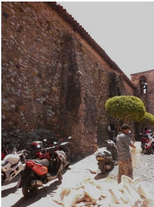
Fig. 2.- Muro norte de la iglesia de San Nicolás Tolentino. Al centro, del lado Izquierdo, aparece un contrafuerte inmerso en el muro norte, mismo que sostenía al muro cabecero de la iglesia primitiva. Fotografía del autor, 2012.
