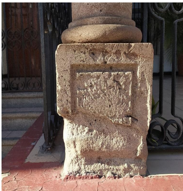
Figura 5: Pieza de cantería severamente deteriorada por la exfoliación en el material, a causa de la presencia de sales vinculadas con la humedad.
