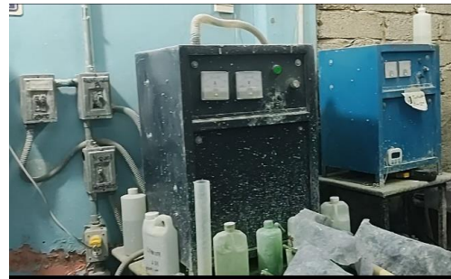
Imagen 5. Rectificador de corriente alterna a directa. Fuente: elaboración propia.
