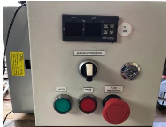
Figura 12. Tablero de control de destiladora de pulque. Fuente: Elaboración propia
