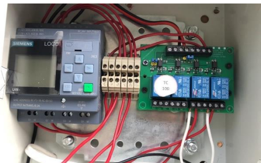
Figura 13. Conexión de PLC con relevadores. Fuente: Elaboración propia
