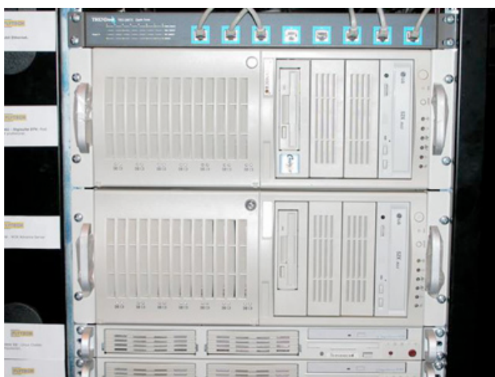
Figura 4.22 Foto de Rack de 41U [42].
