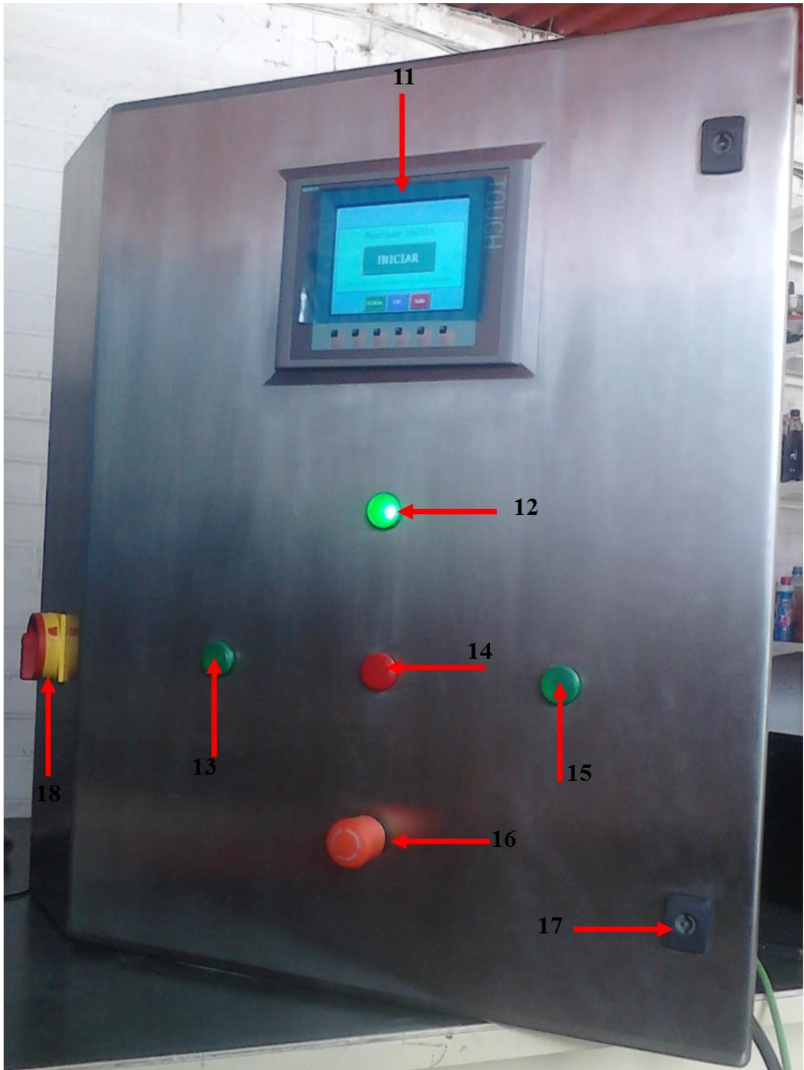
Ilustración 3. 7 Fotografía de la vista frontal del gabinete
