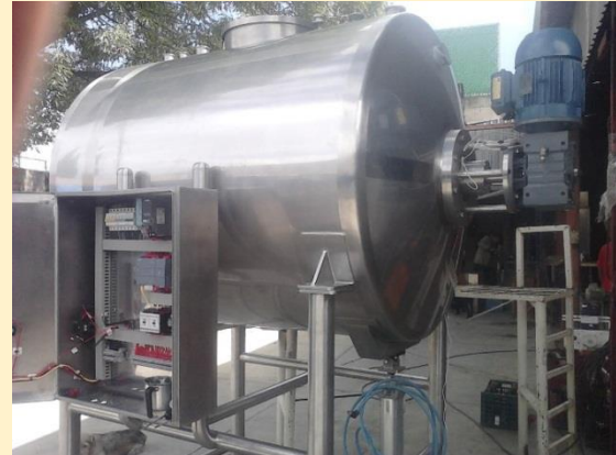
Figura. 6. Vista frontal del Sistema de Control del Tanque Mezclador (Fuente: propia).
