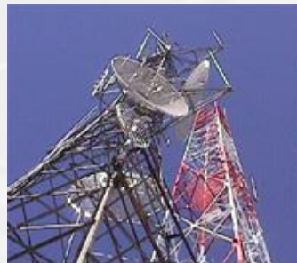
Antenas de microondas
