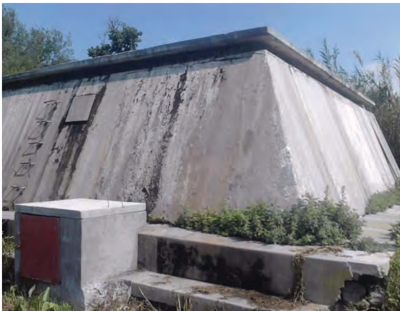
Tanque regulador de agua potable
